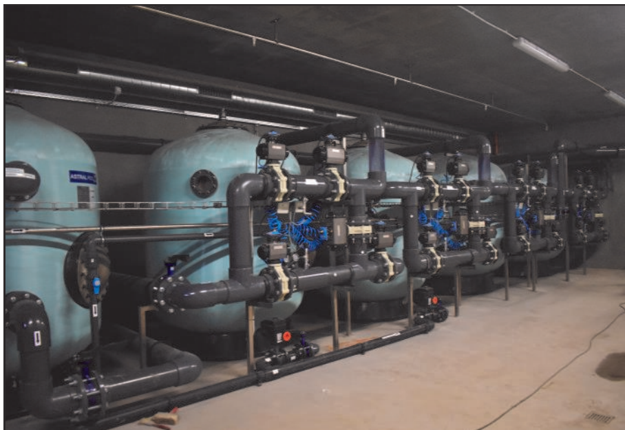
ZOO D.K.n.L. JZ Afrika pavilon Tučňák Z technologie v nadzemní technické místnosti. (rt)
